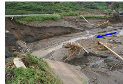
溜池右岸側の護岸の損傷
