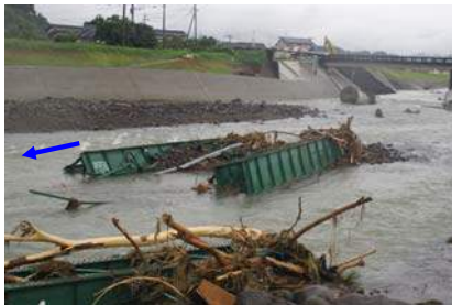
河道に落下している橋桁部
