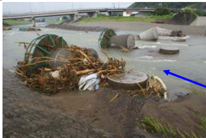
折れた橋脚(4基)
