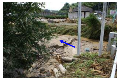
橋梁下流側: 土砂の堆積
