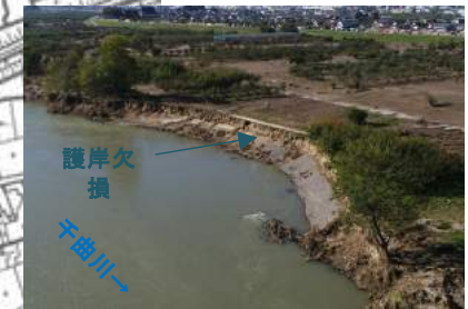
⑥護岸欠損 11月2日 9:20撮影
