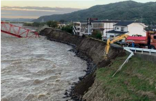
被災状況写真
